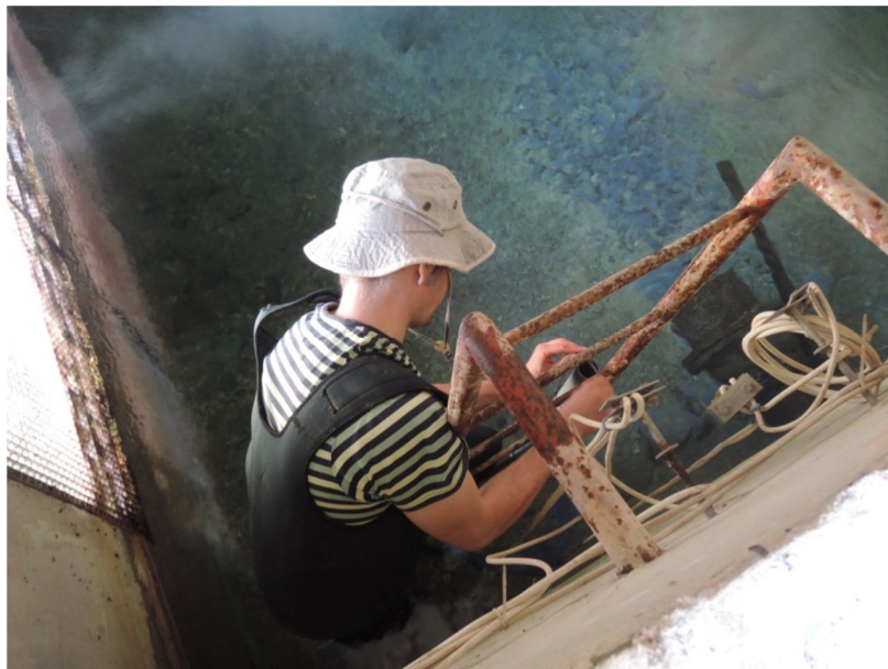
Slika 4. Bazen unutar kaptaže, mjesto postavljanja mjernih uređaja (logera)
